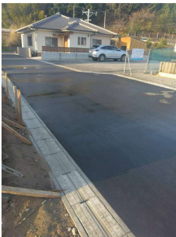
【コンクリート 打設その他】片付・残材の撤去・清掃は完了したか
