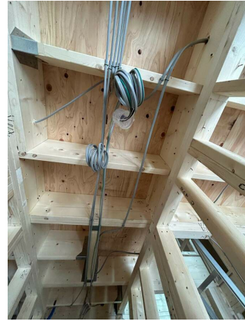
【配線】1F・2F結線部の保護
