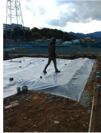
【防湿フィルム】防湿フィルムが施工されている（重ね巾150mm以上）
