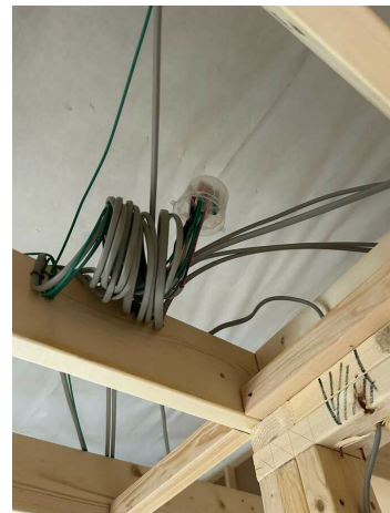
【配線】1F・2F結線部の保護
