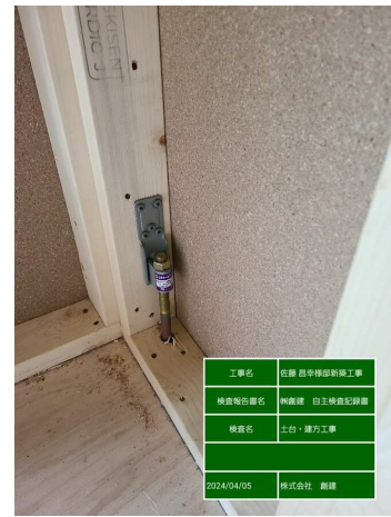
【建方】あおり金物・帯金物・ホールダウンは伏図通りか？
