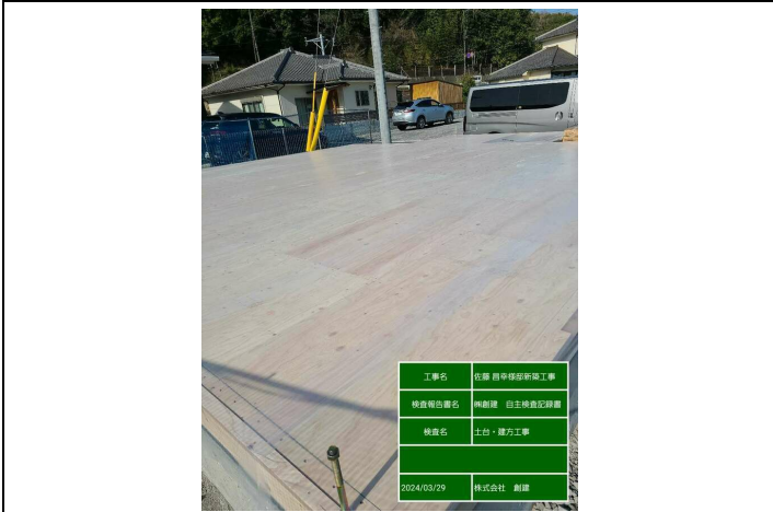
【土台敷き】床合板全景確認・養生シート張り状況※基礎部まで貼り下げ
