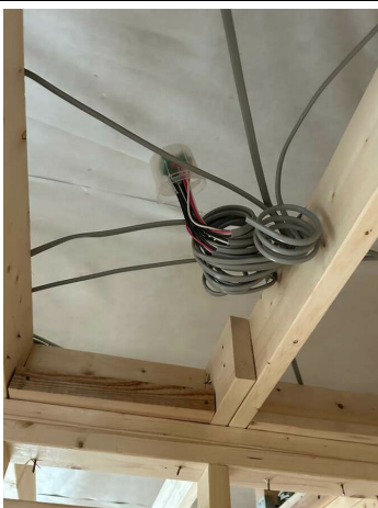
【配線】1F・2F結線部の保護
