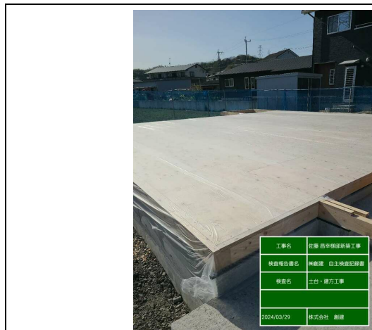
【土台敷き】床合板全景確認・養生シート張り状況※基礎部まで貼り下げ
