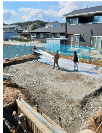
【防湿フィルム】 防湿フィルムが施工されている（重ね巾150mm以上）
