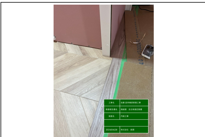
【クッションフロア】貼り付け後の仕上がり確認（凹凸・キズ）
