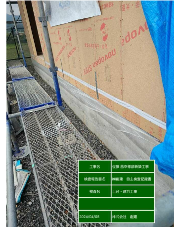
【建方】外部帯合板のジョイントに防水テープは張れているか
