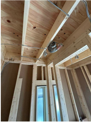
【配線】1F・2F結線部の保護
