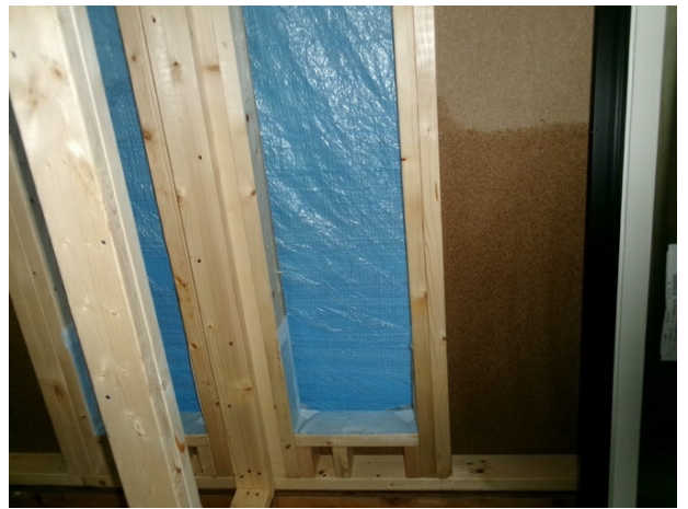
【木部処理】柱・間柱・筋交い・スタッドなど軸組・枠組構造材基礎天端より1.0m以上の吹き付け
