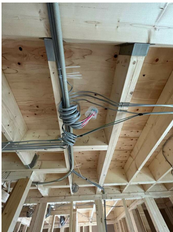
【配線】1F・2F結線部の保護
